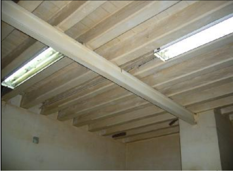
(لوحة ٧) سقف البدروم الخشبي
