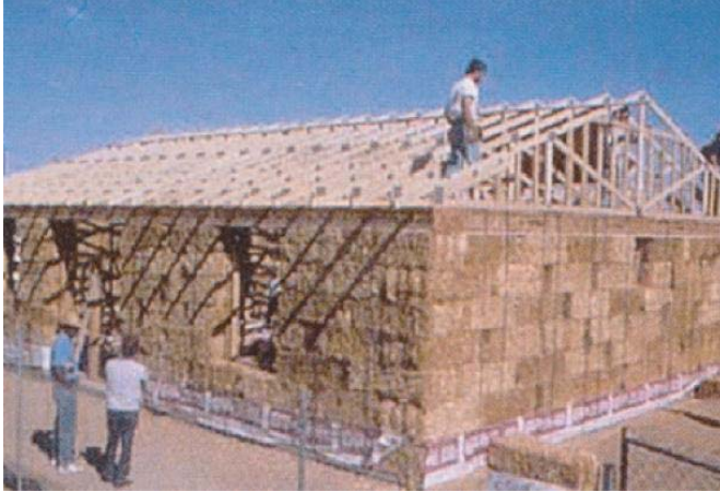
صورة رقم (٣) : القش كمادة بناء في المناطق الصحراوية في هذه العملية من البناء تم خلط القش بالطين.
